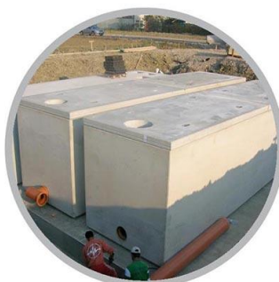
● DEPOSITO ACQUE PIOVANE
